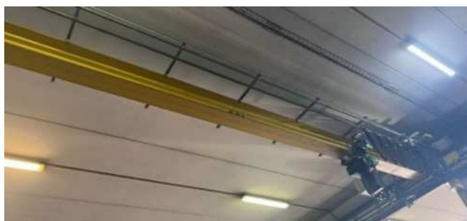
Figura 23 - Ponte rolante com capacidade máxima de 5 toneladas.
