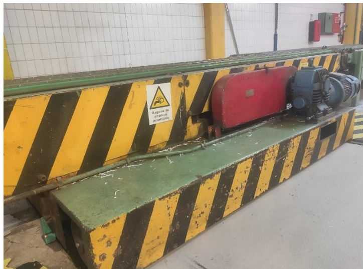
Figura 22 - Transportador acionado eletricamente (Navigator Pulp Aveiro, 2023).
