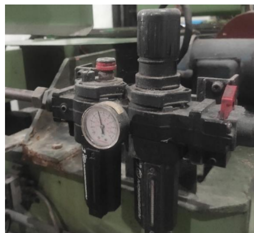
Figura 19 - Regulador de pressão pneumática com patilha de despressurização (Navigator Pulp Aveiro, 2023).
