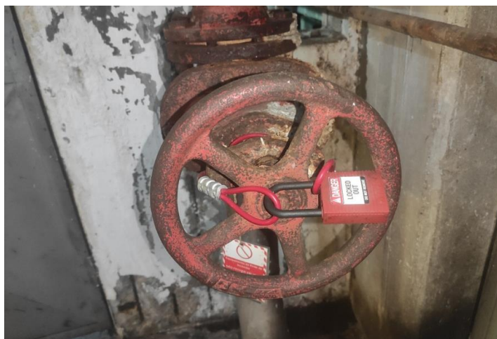
Figura 26 - Válvula de alimentação de água para rede de incêndios (Navigator Pulp Aveiro, 2023).
