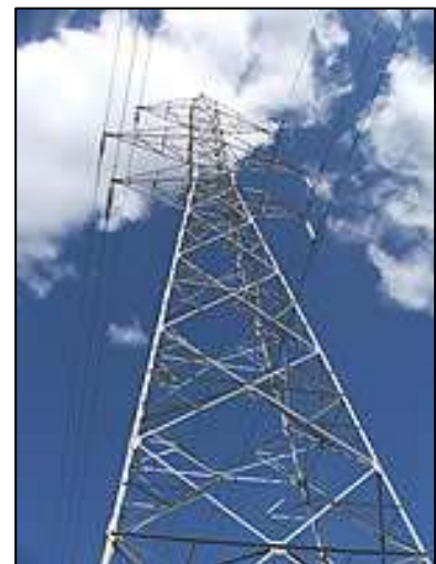
Figura 9 – Energia Eléctrica. www.ageneal.pt
