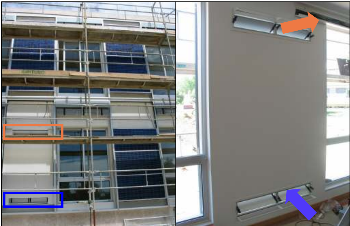
Figura 132– Edifício Solar XXI do INETI – Aproveitamento Térmico do sistema fotovoltaico; Aquecimento por convecção natural, o ar interior da sala aquece ao circular entre a parede e o painel (em contacto com a superfície interior dos painéis fotovoltaicos) reentrando aquecido na sala. http://www.ineti.pt
