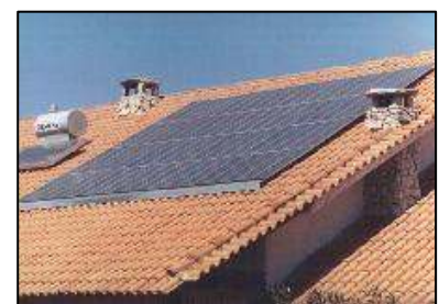
Figura 113 – A “Casa Solar” em Freixo de Espada à Cinta – painéis solares Fotovoltaicos.
