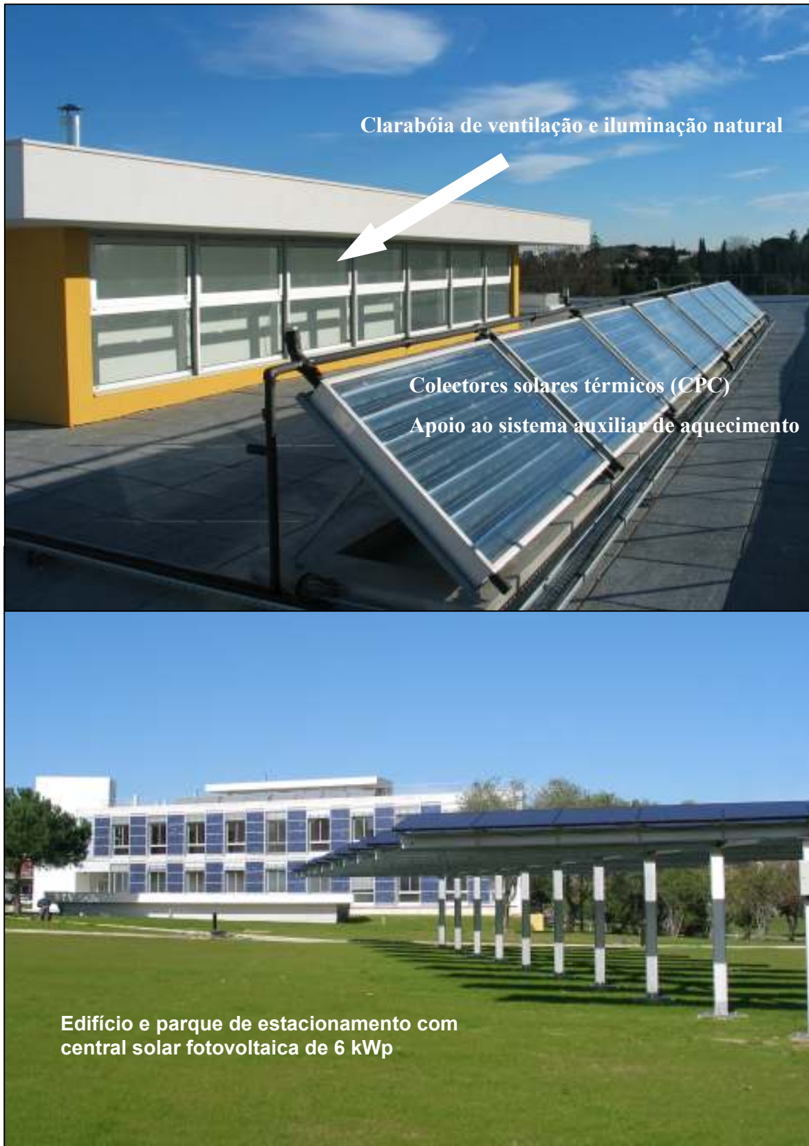
Figura 129 – Edifício Solar XXI do INETI – Colectores Térmicos instalados na cobertura para aquecimento; painéis fotovoltaicos no parque de estacionamento para produção de electricidade.
