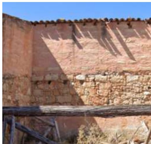
Ilustração 8 – Ruína de construção de tufo calcário perto de Rio Maior. (Ilustração nossa, 2021)
