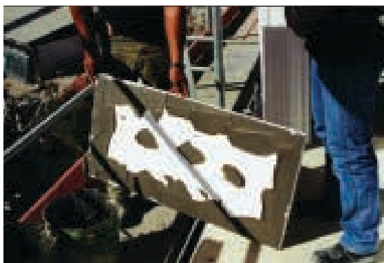
Ilustração 134 – Placa de isolamento térmico com argamassa de colagem do sistema ETICS aplicar nas paredes exteriores do edifício da Faculdade de Ciências de Lisboa. (Pinto, 2001, p. 308).
