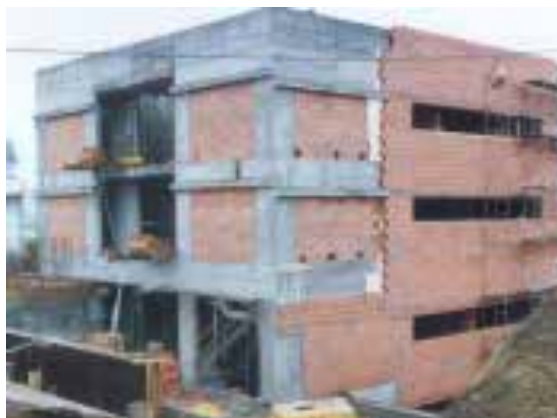
Ilustração 77 – Execução de parede de alvenaria em tijolo vazado de duplo pano com isolamento térmico no interior. (Freitas e Gonçalves, P., 2005, p. 9).
