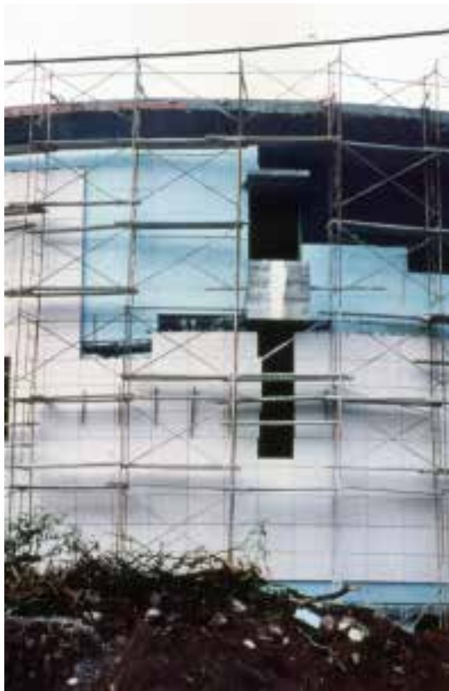
Ilustração 172 –Pormenor de fachada ventilada em fase de construção do edifício da Câmara de Oliveira do Bairro, 1999. (Pinto, 2020).
