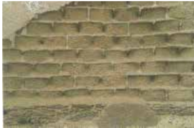
Ilustração 28 – Alvenaria de adobe sobre fundação de pedra no Alentejo. (Coelho, Torgal e Jalali, 2009, p. 61).
