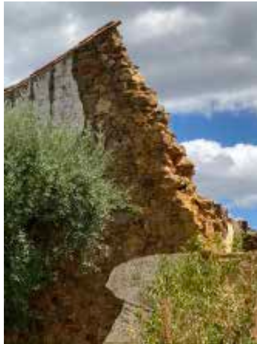
Ilustração 44 – Parte de ruína com parede de alvenaria de pedra ordinária exposta por destacamento do reboco. (Ilustração nossa, 2020).
