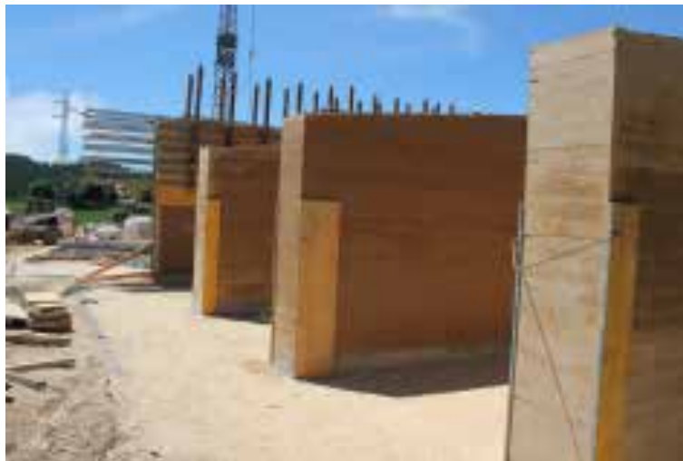
Ilustração 19 – Execução de paredes em taipa mecanizada em diferentes fases. (Betão e taipa, 2020).
