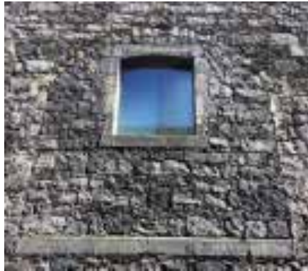
Ilustração 228 – Caixilho oculto pelo interior, vão preexistente visivelmente marcado. (Ilustração Nossa, 2017)
