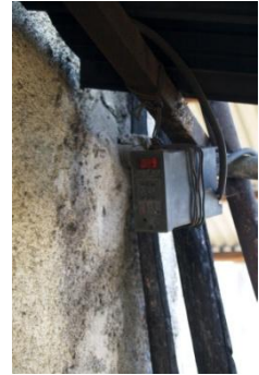
Fig.90 - Termómetro para controlar a temperatura do forno
