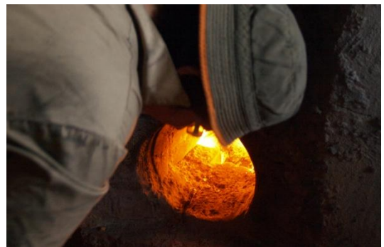
Fig.53 - Alimentação da fornalha
