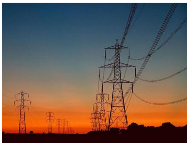
Figura 5: Postes de média e alta tensão.
