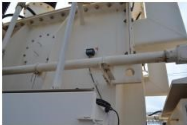
Figura 65: Sensor piezelétrico acoplado ao tanque de um transformador [95].
