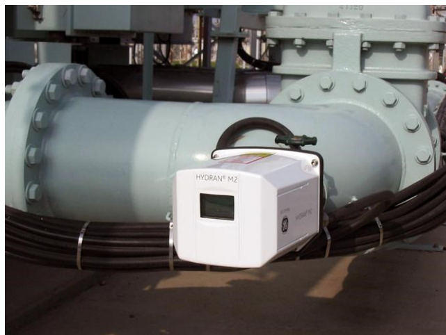
Figura 62: Monitorização de gases e humidade num transformador de potência [77].
