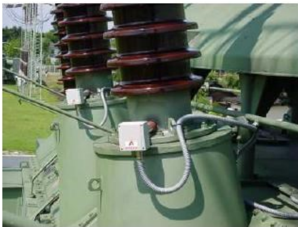
Figura 64: Sensor de tensão instalado nas travessias [91].
