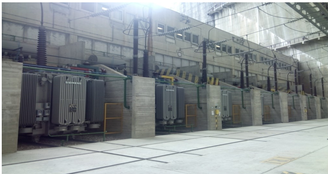
Figura 1: Transformadores elevadores da subestação da Aguieira 15/220kV (EDP).
