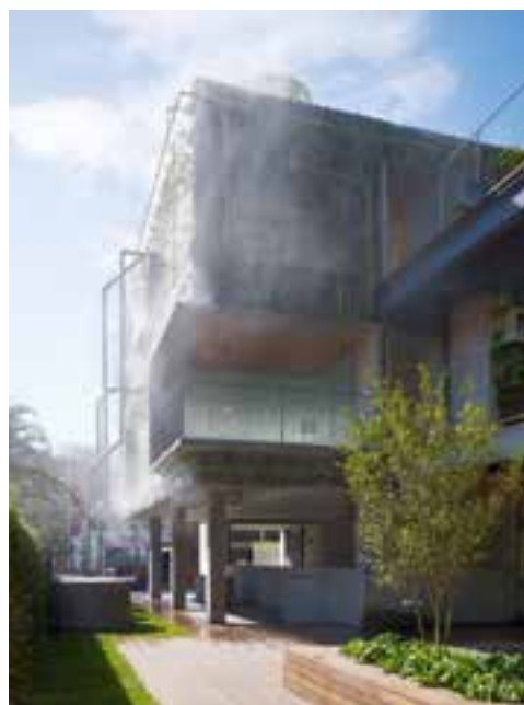
Ilustração 101 – Canalizações exteriores, com o sistema de rega ligado. (Duran & Fajardo, 2010, p. 59)
