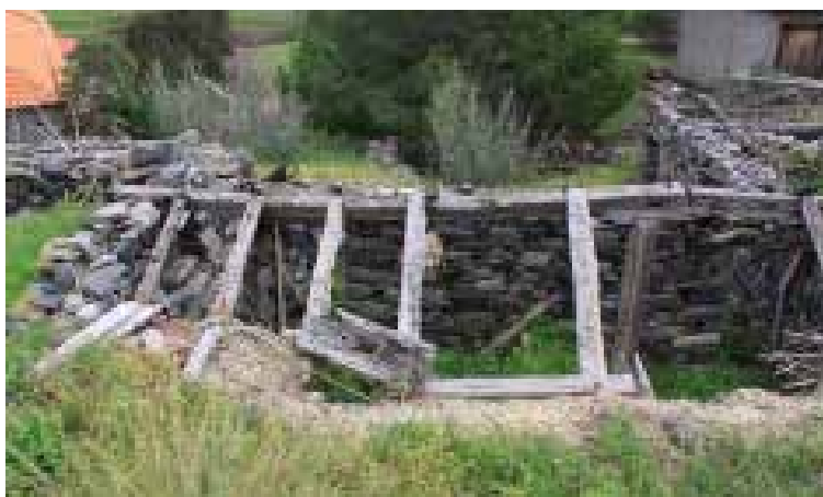
Ilustração 269 – Ruína de edificação. Pormenor dos caibros na cobertura de salão. (Ilustração nossa, 2016).
