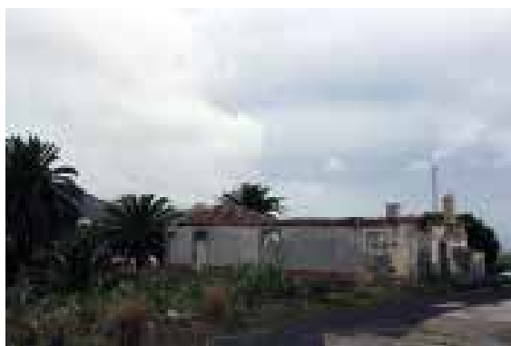
Ilustração 32 – Casa complexa com telhados múltiplos em ruínas. (Ilustração nossa, 2016).
