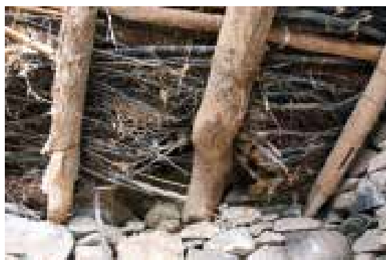
Ilustração 205 – Caibros e tamargueira da cobertura de salão no interior do palheiro e estábulo. (Ilustração nossa, 2016).
