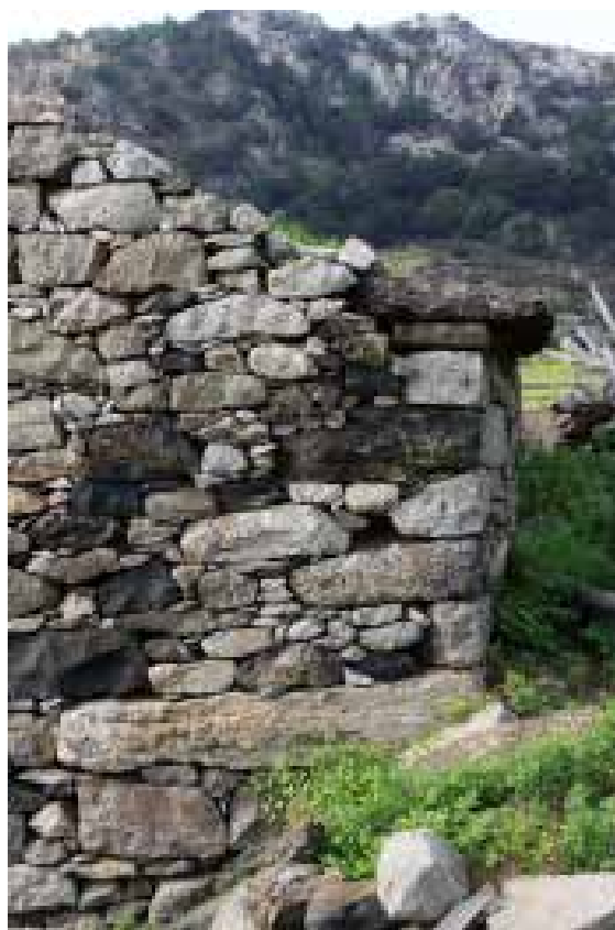
Ilustração 204 – Parede exterior da edificação composta pelo palheiro e estábulo – Fachada Este. (Ilustração nossa, 2016).
