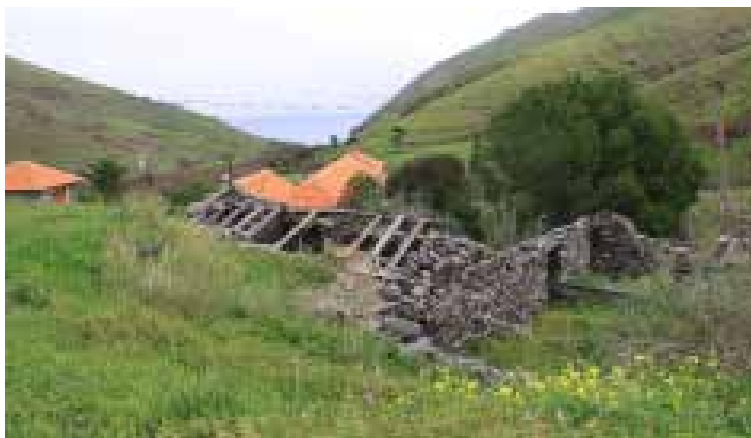
Ilustração 268 – Ruína de edificação com cobertura de salão. (Ilustração nossa, 2016).
