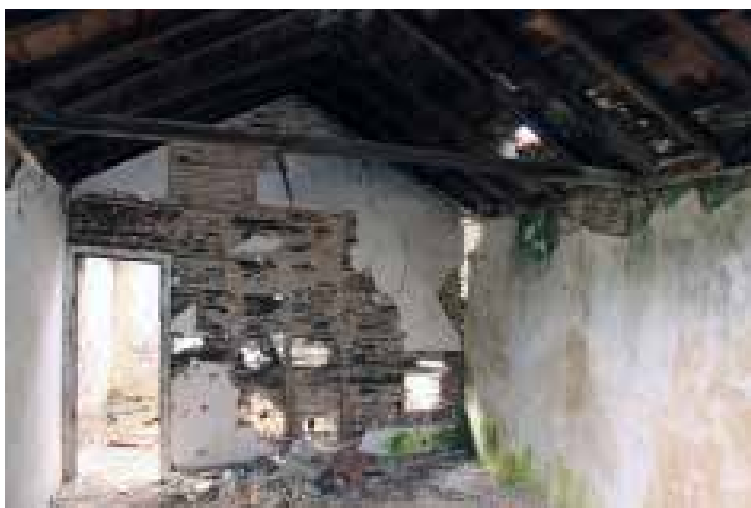
Ilustração 192 – Sala de entrada. Parede divisória entre esse compartimento e a cozinha. (Ilustração nossa, 2016).
