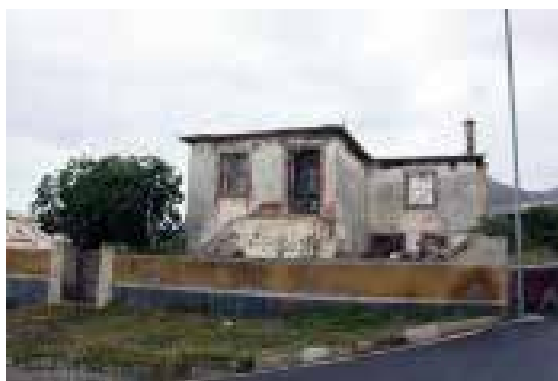
Ilustração 33 – Casa complexa com telhados múltiplos em ruínas (Ilustração nossa, 2016).
