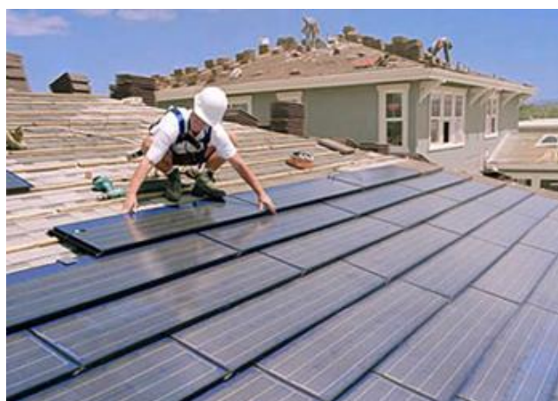
Ilustração 17 – Painéis Solares de dupla função (Google Photos)
