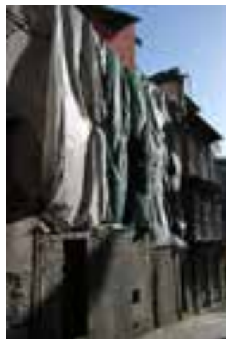
Ilustração 97 - Fachada da Rua dos Mercadores antes da intervenção – Operação A (PORTO VIVO, SRU, 2015)
