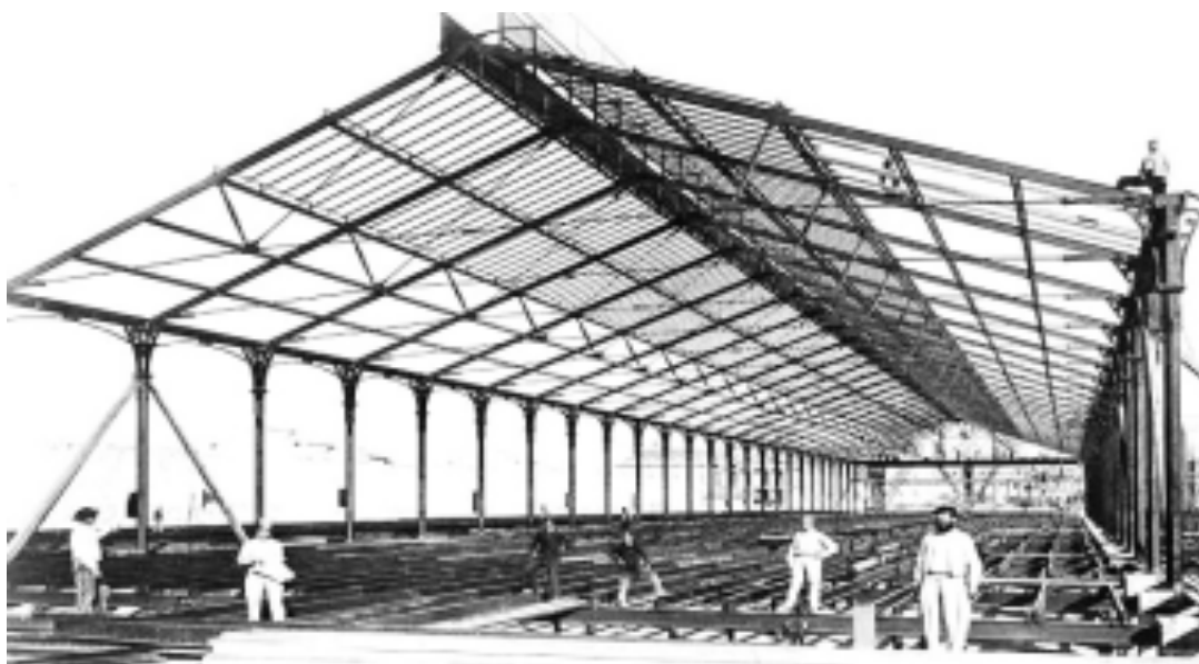
Ilustração 6 – Palácio do Trocadéro em construção (Paris, França), projeto dos Arqts. Davioud e Bourdais. (H. Klerjot, 1878)
