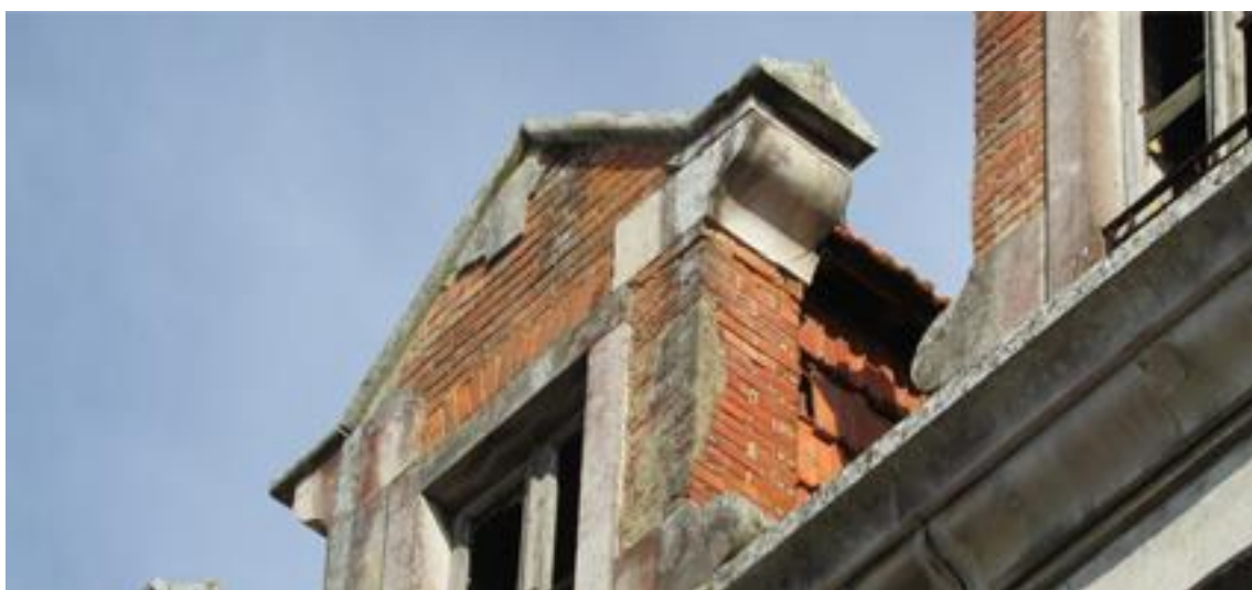
Ilustração 55 - “Patologia não estrutural nos Pavilhões do Parque”, André Barros. (Ilustração nossa, 2014)
