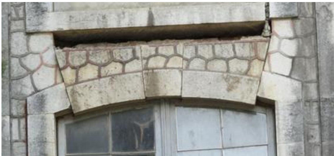
Ilustração 54 – “Patologia estrutural nos Pavilhões do Parque”, André Barros. (Ilustração nossa, 2014)
